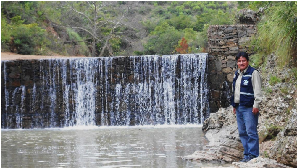
Dique de control de sedimentos (Cuenca Escaleras). Fuente: Gobierno Autónomo Departamental de Chuquisaca.
