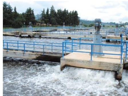
Tratamiento de aguas residuales en Méjico http://www.miambiente.com.mx/?p=1020
