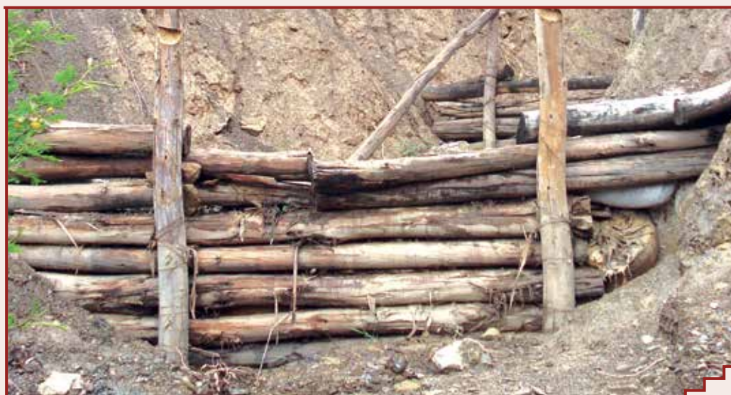
▲ Se pueden aplicar diferentes medidas para evitar el daño a la infraestructura de las represas (Trampas de sedimentación - Caigua (Tatija).
